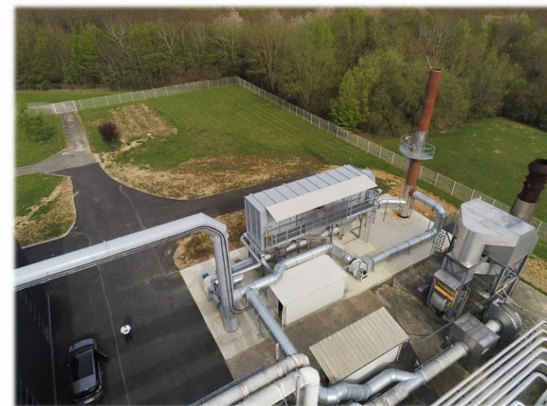
Optimisation et maintenance des incinérateurs COV
