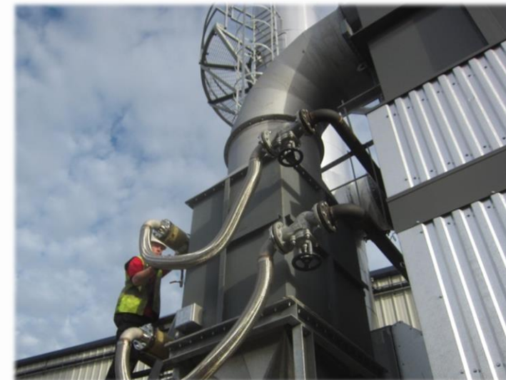
Récupération d'énergie sur incinérateurs COV
